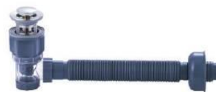
SYF-E11 Basin waste
